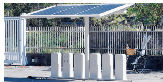
La pensilina solare prototipale per la ricarica di bici elettriche
